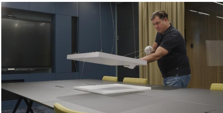
Die Lieferung, Installation und Einrichtung des Sennheiser Deckenmikrofons übernahm die Schweizer Supravisio AG
